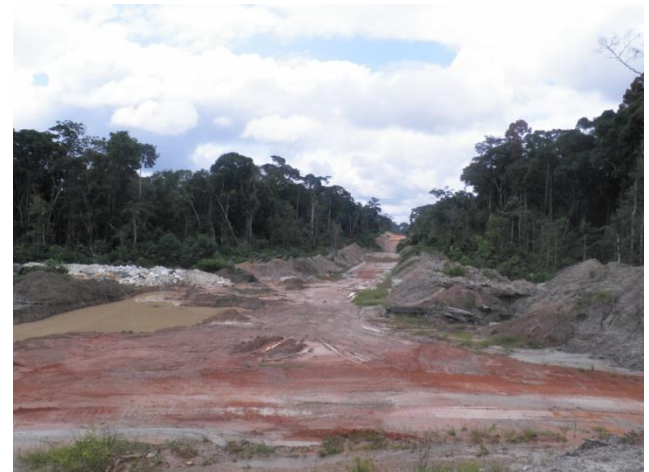
Ouverture pour ligne de d'évacuation (transport)
