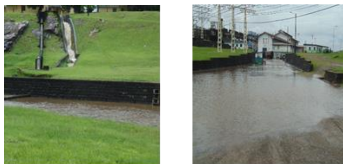
Figure 5 : Trop plein de la conduite d'évacuation d'eau de pluie à la centrale hydro-électrique d'Edéa
